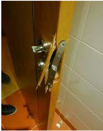
PUERTA CON CERRADURA ESTROPEADA
