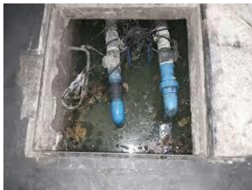
Planta Elevadora Saturada y sin Mantenimiento
