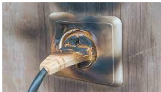
ENCHUFES EN MAL ESTADO
