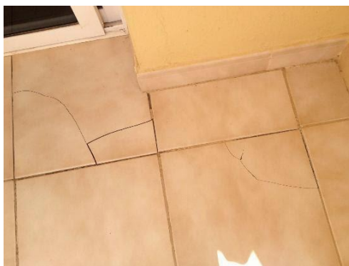
PALMETAS MAL ESTADO
