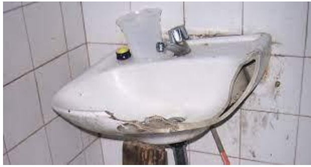
LAVAMANOS EN MAL ESTADO (NO OPERATIVO)
