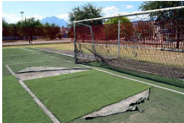
CANCHA PASTO SINTÉTICO MAL ESTADO
