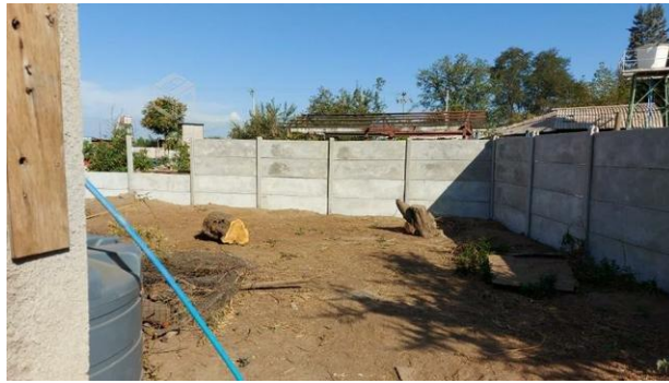
Cierro tipo Buldog en mal estado
