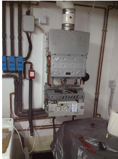
Calderas desarmadas y no operativas
