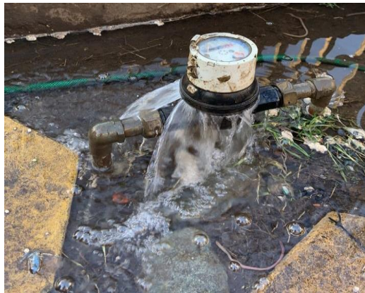
MEDIDOR AP EN MAL ESTADO
