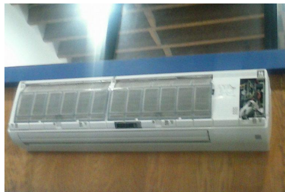
Equipos splits en mal estado
