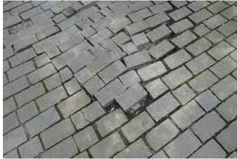
PAVIMENTO EXTERIOR MAL ESTADO
