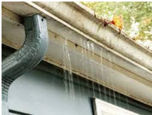
CANALETAS CON FILTRACIONES
