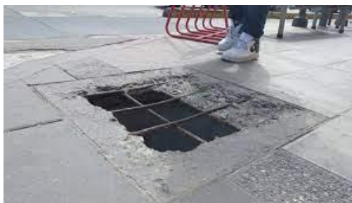
TAPAS DE CÁMARAS ESTROPEADAS
