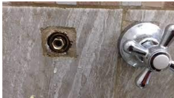
GRIFERÍA EN MAL ESTADO O SIN SUS DISPOSITIVOS
