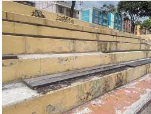
GRADERÍAS SIN MANTENIMIENTO
