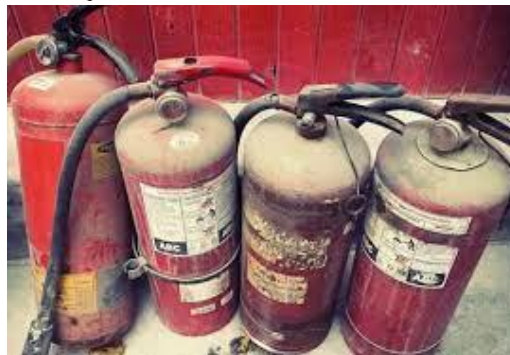
Extintores en mal estado y no operativos
