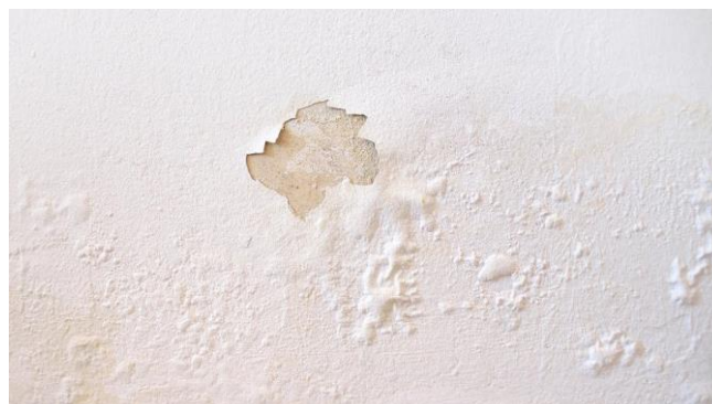
PINTURA CON HUMEDAD Y DESCASCAMIENTO
